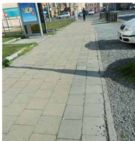
Chodník v Aksamitově ulici před opravou...
